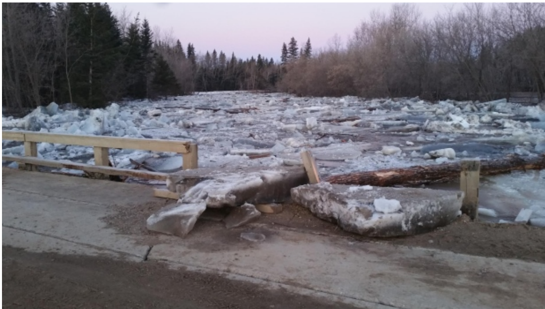
Figure 7 – Pont endommagé par un embâcle, Torch River au Manitoba, 2017 (Municipalité régionale de Torch River)
