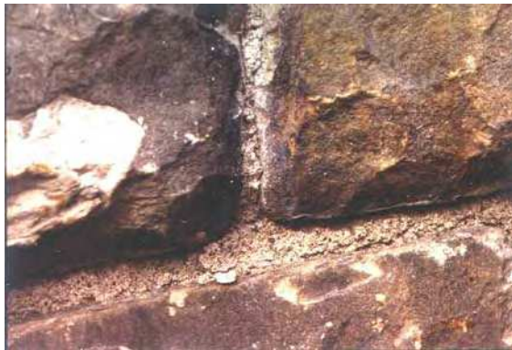
Figure 3 La détérioration prématurée de ce joint de mortier est probablement la conséquence de l'action du gel et d'une mauvaise cure.
