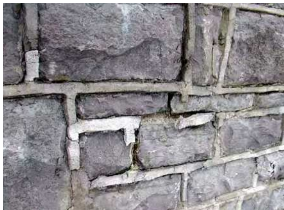
Figure 4 Le mortier de rejointoiment dense et dur a été poussé vers l'extérieur par les dommages du gel infligés au mortier d'assise. Le mortier de rejointoiment dense réduit considérablement la capacité de séchage du mur et favorise l'accumulation d'humidité dans le mur. La fissuration du joint entre le mortier et la pierre favorise considérablement les infiltrations d'eau. La qualité esthétique des joints est faible.
