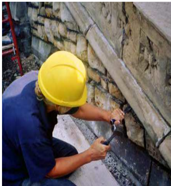
Figure 9 Dégarnissage des joints de mortier ancien à l'aide d'un maillet et d'un burin.
