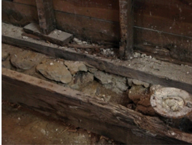
Figure 7.3 : Lisse basse endommagée
