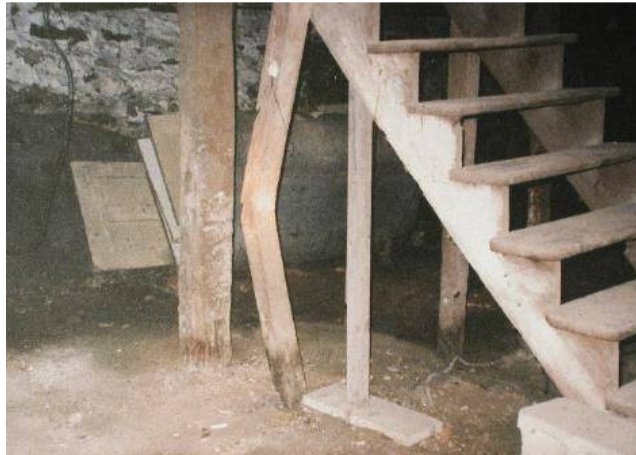
Figure 7.1 : Poteaux en bois pourris
